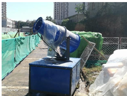
洒水降尘设施（2018.9）
